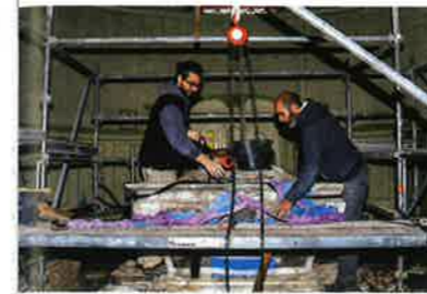
Très endommagé, le maître-autel a été complètement démonté ; son massif, situé à l'intérieur, a été démolé afin d'en construire un nouveau.
