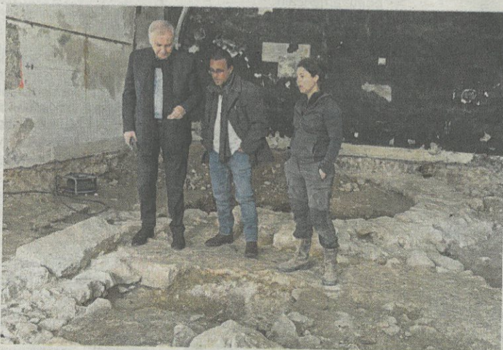
Pour Régis Lebigre, maire de Vence, c'est « un événement exceptionnel ». Sur le chantier – qui va être transformé en temple de l'archéologie – il est accompagné des experts du service archéologique de la Métropole, Fabien Blanc Garidel et Émilie Sanchez.
